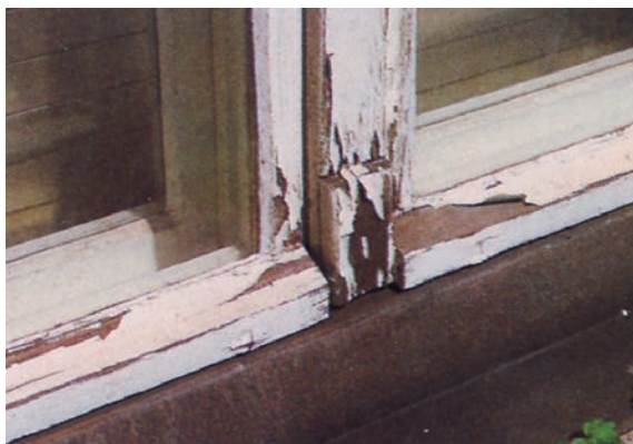
Huellas de humedad y bacterias en una ventana de madera de una vivienda situada al lado del mar.
